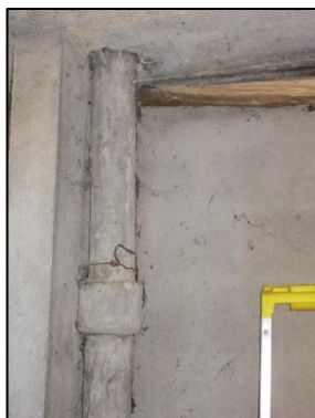
Photo N° 25 ECH-N°001 AMIANTE CIMENT Local poubelle 1 Murs Chute E.P.(Fibres-ciment)
